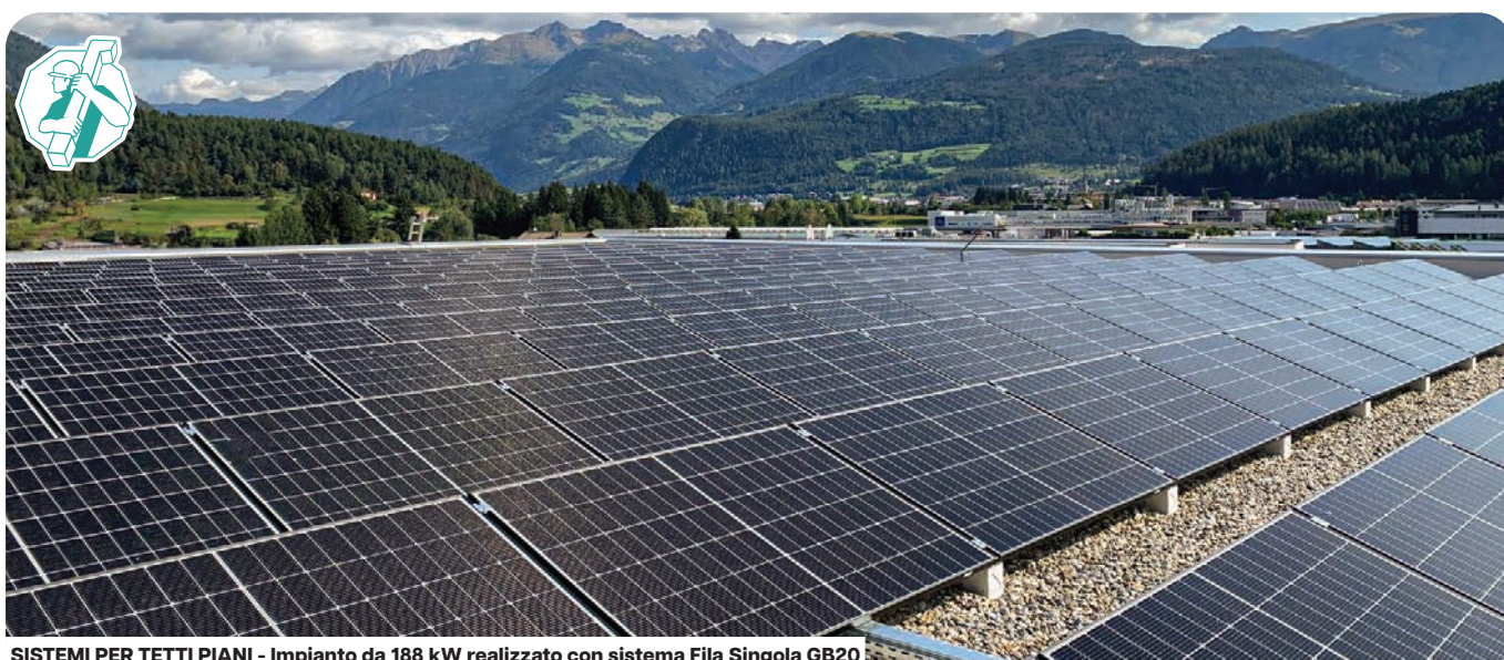
SISTEMI PER TETTI PIANI - Impianto da 188 kW realizzato con sistema Fila Singola GB20
