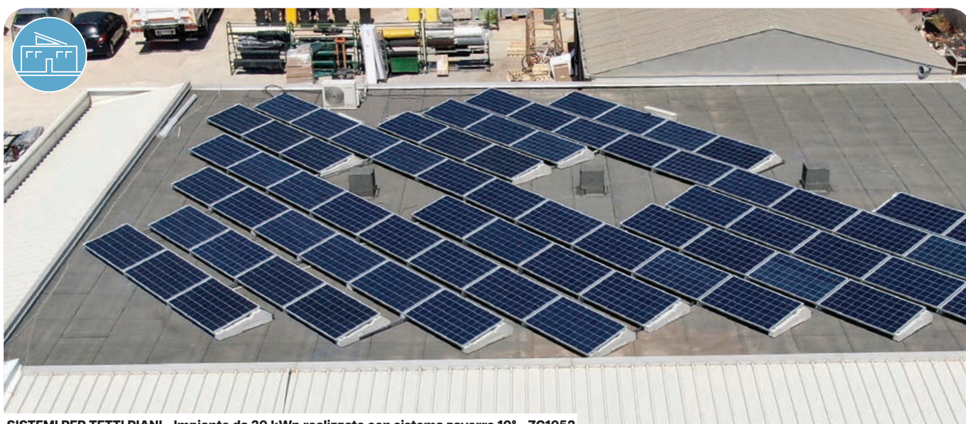
SISTEMI PER TETTI PIANI - Impianto da 30 kWp realizzato con sistema zavorre 10° - ZC1052
