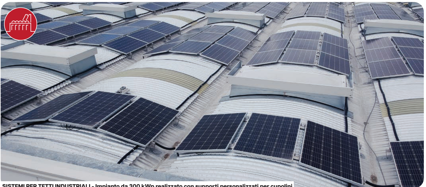
SISTEMI PER TETTI INDUSTRIALI - Impianto da 300 kWp realizzato con supporti personalizzati per cupolini
