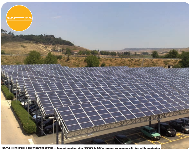
SOLUZIONI INTEGRATE - Impianto da 300 kWp con supporti in alluminio
