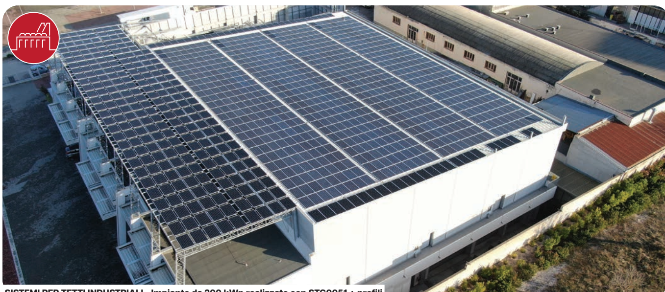
SISTEMI PER TETTI INDUSTRIALI - Impianto da 200 kWp realizzato con STG0051 + profili
