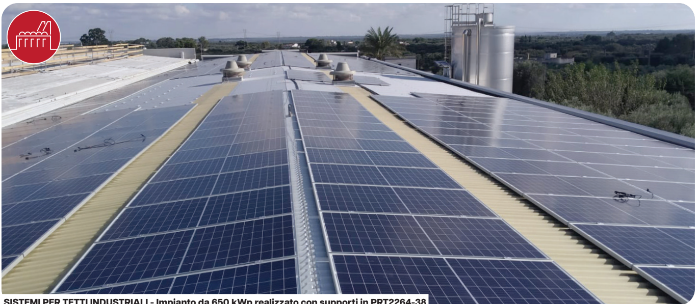
SISTEMI PER TETTI INDUSTRIALI - Impianto da 650 kWp realizzato con supporti in PRT2264-38
