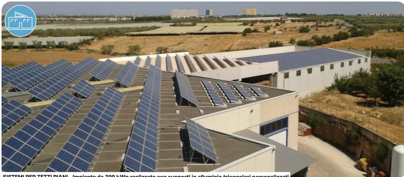
SISTEMI PER TETTI PIANI - Impianto da 399 kWp realizzato con supporti in alluminio triangolari personalizzati
