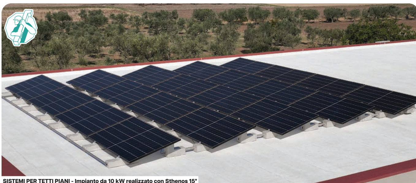
SISTEMI PER TETTI PIANI - Impianto da 10 kW realizzato con Sthenos 15°
