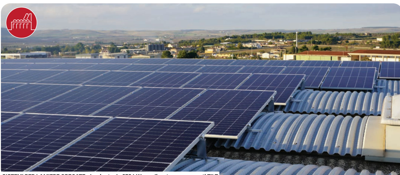
SISTEMI PER LAMIERE GRECATE - Impianto da 272 kWp realizzato con supporti TILT
