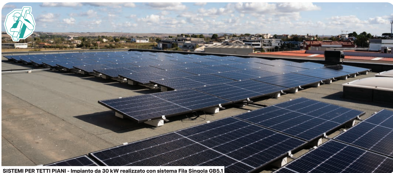
SISTEMI PER TETTI PIANI - Impianto da 30 kW realizzato con sistema Fila Singola GB5.1
