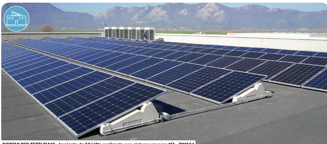
SISTEMI PER TETTI PIANI - Impianto da 50 kWp realizzato con sistema zavorre 15° - ZC1564
