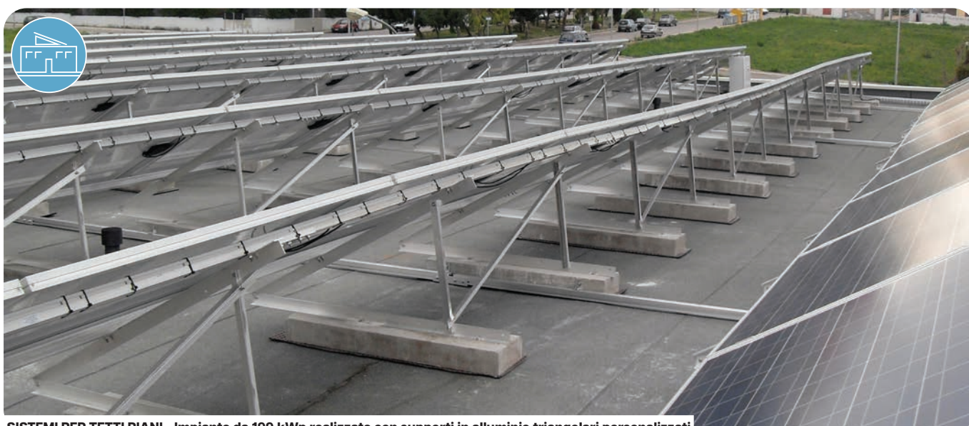
SISTEMI PER TETTI PIANI - Impianto da 199 kWp realizzato con supporti in alluminio triangolari personalizzati
