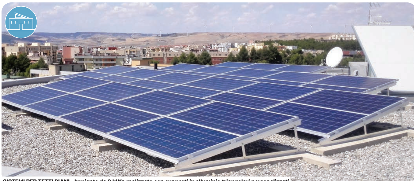
SISTEMI PER TETTI PIANI - Impianto da 9 kWp realizzato con supporti in alluminio triangolari personalizzati
